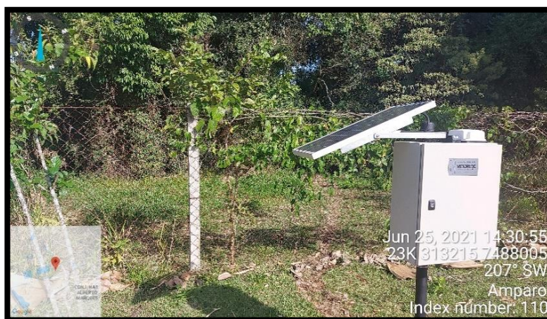
Foto 3 – Estação Limnográfica instalada no PHM. Foto de jun./2021
