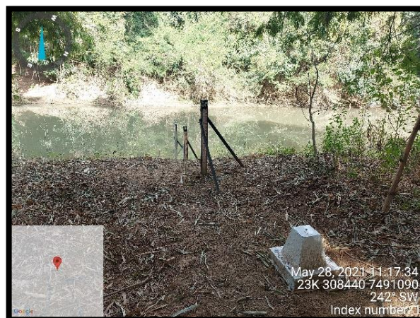
Foto 2 - Equipamento instalado no PSed. Foto de mai/2021
